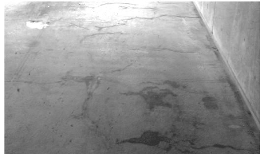
写真1 高強度コンクリートを用いたスラブに発生したひび割れ
